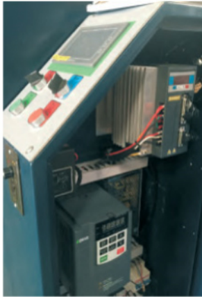
Автомат по резке резины
