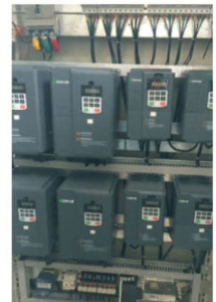
Система очистки воды
